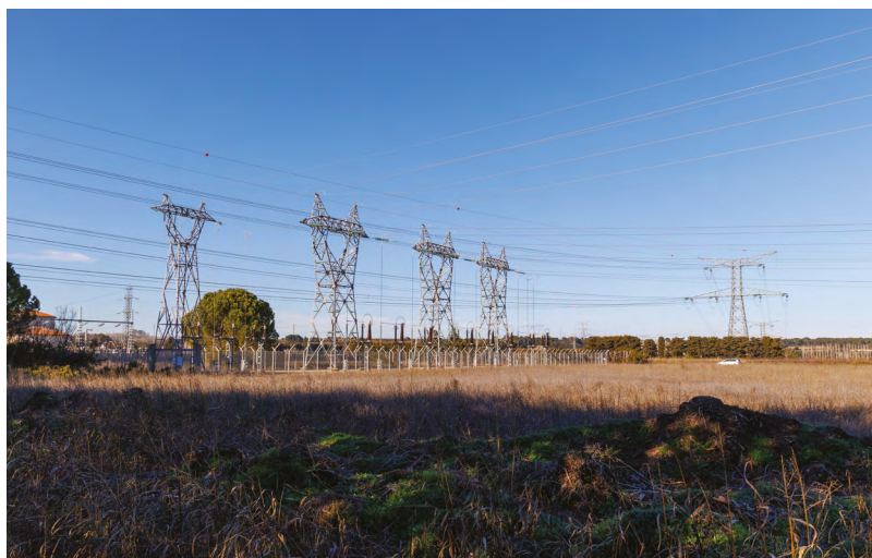
Ligne aérienne à 400 000 double circuit REALTOR-TAVEL en sortie du poste de JONQUIERES (pylône type F44) et arrivées au poste (pylônes L1)
